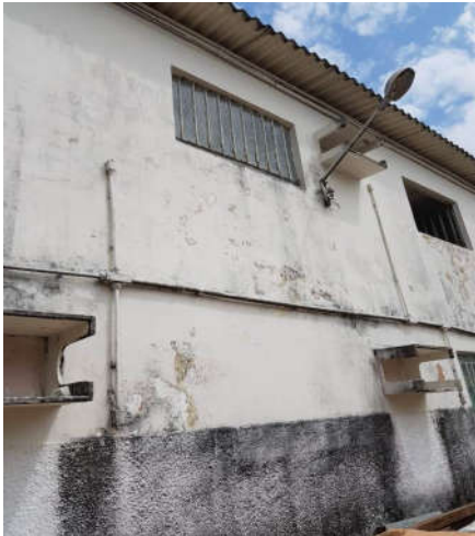
Figura 3: Estado da fachada do bloco colado na divisa poente
