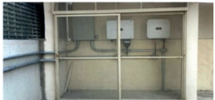
Usina de energia solar para geração de energia elétrica
