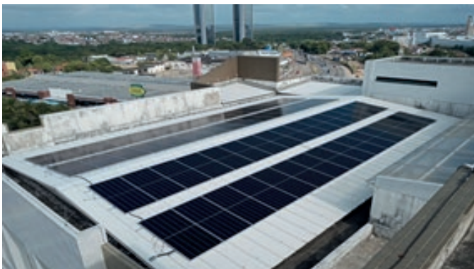
Usina de energia solar para geração de energia elétrica
