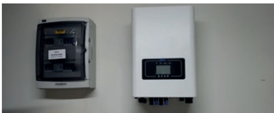
Inversores instalados na sala climatizada do servidor de internet
