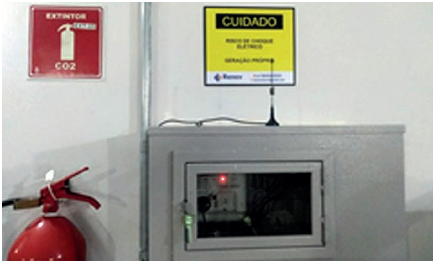
Inversores de corrente contínua, instalados nas dependências do Fórum Maximiano Figueiredo
